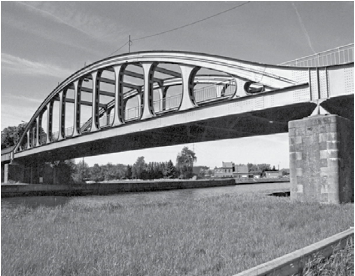
De huidige Vierendeelbrug over het Albertkanaal te Oelegem, zoals gefotografeerd op de OMD programmabrochure uit 2001.
