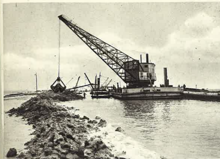
Fig. 275. Stork-grijperkranen aan de afsluitdijk (1932). Deze kranen deden ook dienst voor Walcheren (1945) en Engeland (1947)
