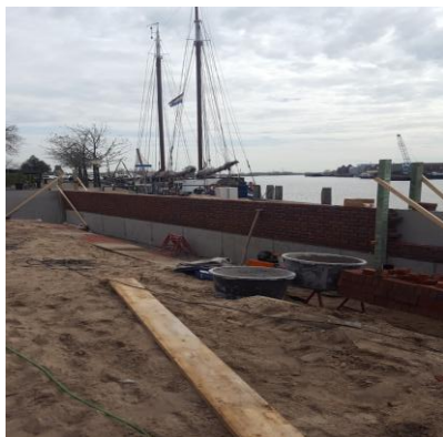
Extra hoge muren beschermen de boulevard bij hoogwater
